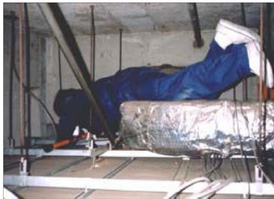
電気工による天井内で横に這いながらの作業で、写真の下に部屋があります。電気工、水道工、ダクト工、衛生設備工は天井内作業があり、写真はありますが天井に石綿吹きつけがある場合、壁をこすって、石綿にばく露することがあります。
