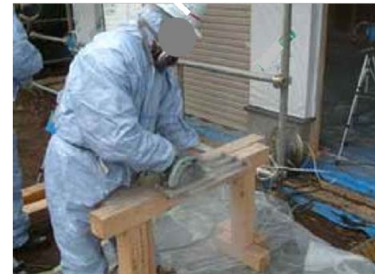
屋根工が、石綿含有の波型スレートを切断する作業です。屋根材、壁材、床材等、建築現場には石綿含有製品が多く、このように現場で切断作業を行うことにより、現場で粉じんが発生します。
