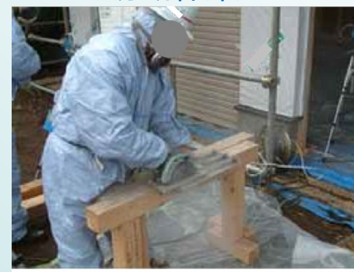
屋根工が、石綿含有の波型スレートを切断する作業です。屋根材、壁材、床材等、建築現場には石綿含有製品が多く、このように現場で切断作業を行うことにより、現場で粉じんが発生します。
