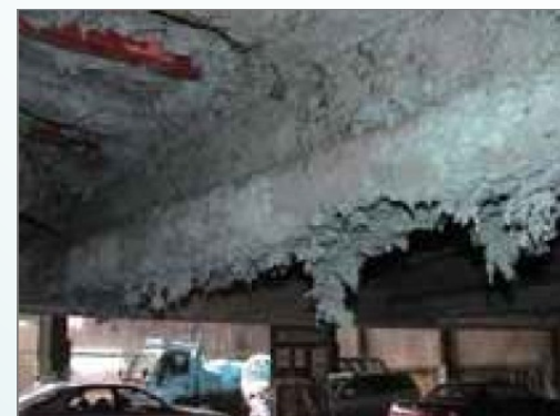
吹きつけ石綿(青石綿) (劣化のため、天井から垂れ下がっています)
